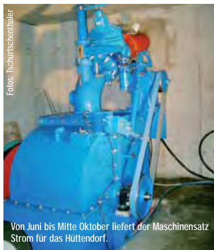
Die eindüsige Pelton-Turbine von Tschurtschenthaler bringt eine Leistung von rund 35 Kilowatt.
